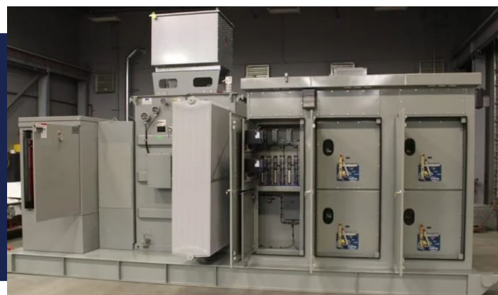
Subestación Movil Tipo Skid
