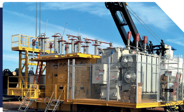
Subestación Móvil Tipo Tracto / MV & HV
